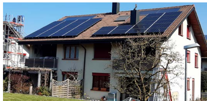
Zwei fertig erstellte Photovoltaikanlagen in Schänis links mit 6.2 kWpeak und rechts 4.3 kWpeak.
